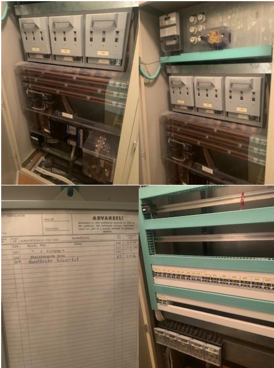
Tavlerom, hovedinntak til 1982 delen av skolen, store sikringer..
