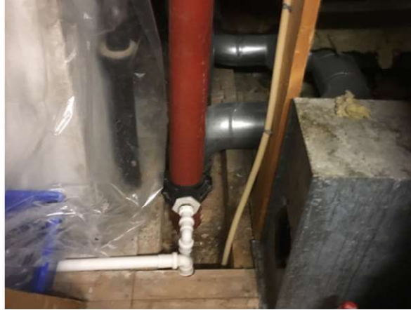
Figur 2.1.2.2– 14 Avløp på loft
