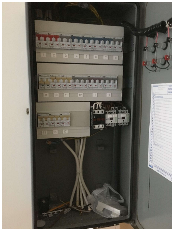
Figur 2.1.3.2– 9 Sikringssskap sløyde, skolekjøkkenen
