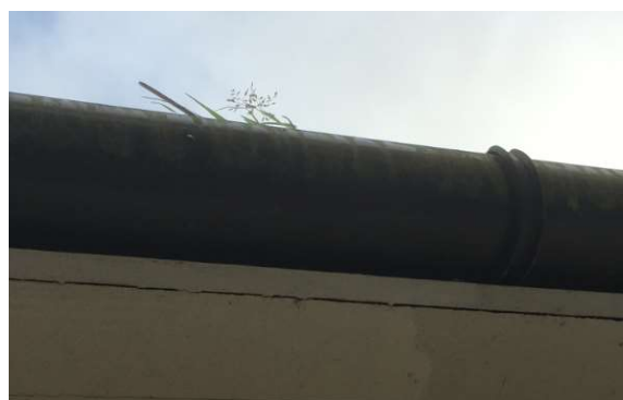
Figur 2.1.1-6 – I takrenne vokser gress
