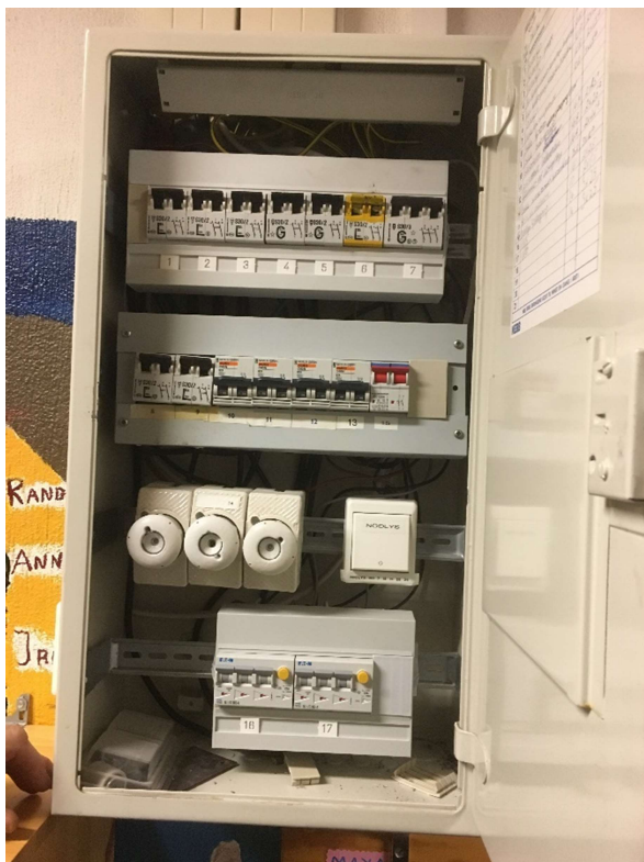
Figur 2.1.3.2– 3 Sikringsskap underetasje korridor
