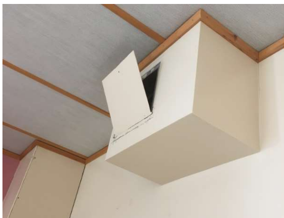
Figur 2.1.2.2– 9 Luftesystem 1. etasje klasserom
