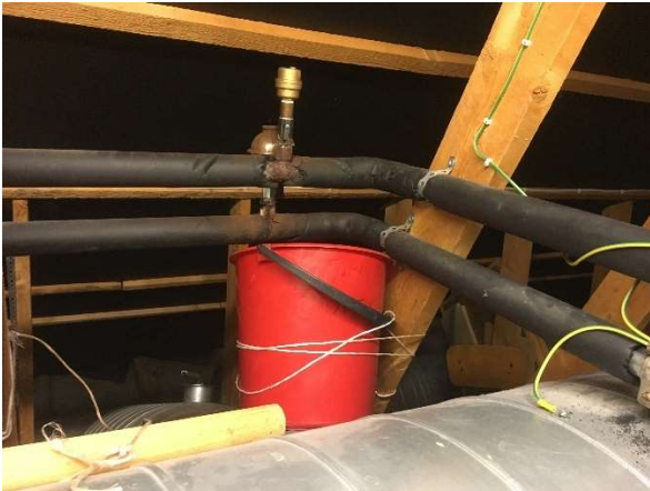
Figur 2.1.2.2– 13 Rør på loft
