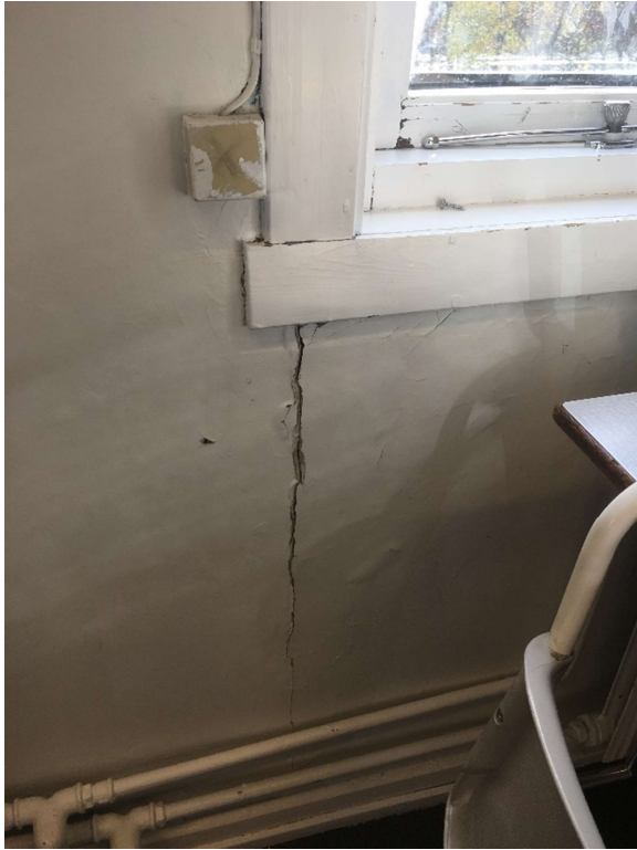
Figur 2.1.1-33 – Vildu 2. etasje – tidligere fuktskade
