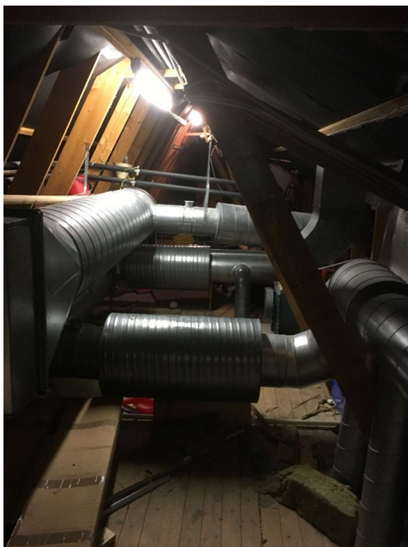
Figur 2.1.2.2– 19 Ventilasjon på loft
