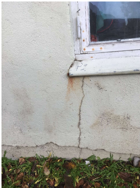
Figur 2.1.1-2 – Skader i veggoverflate
