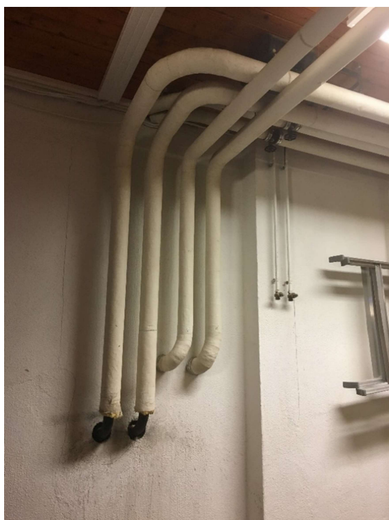
Figur 2.1.2.2- 1 Rør i korridor underetasje
