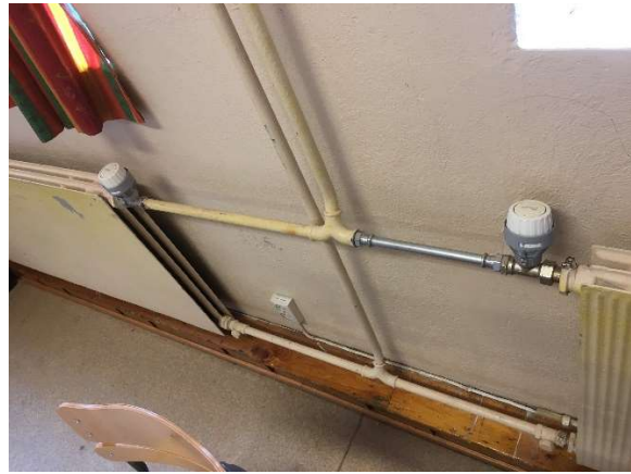
Figur 2.1.1-16 – Veggradiator i SFO
