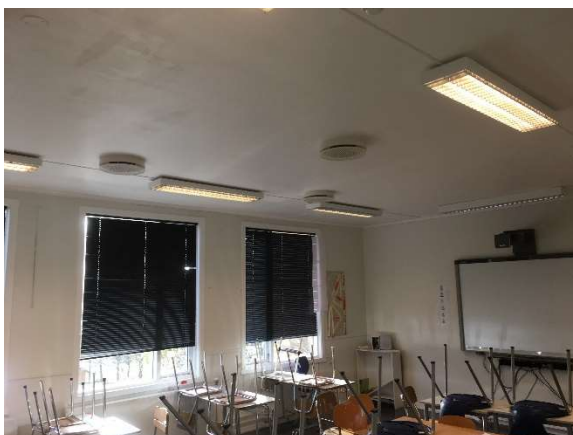
Figur 2.1.1-31 – Klasserom 2. etasje med ventilasjon
