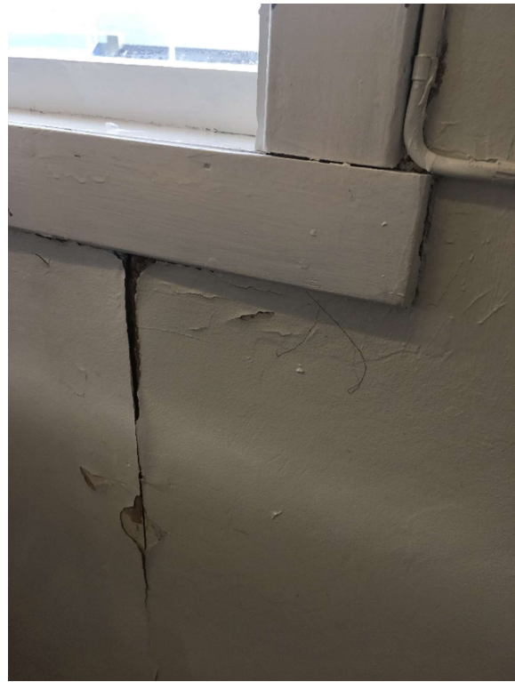
Figur 2.1.1-34 – Vindu 2. etasje – tidligere fuktskader
