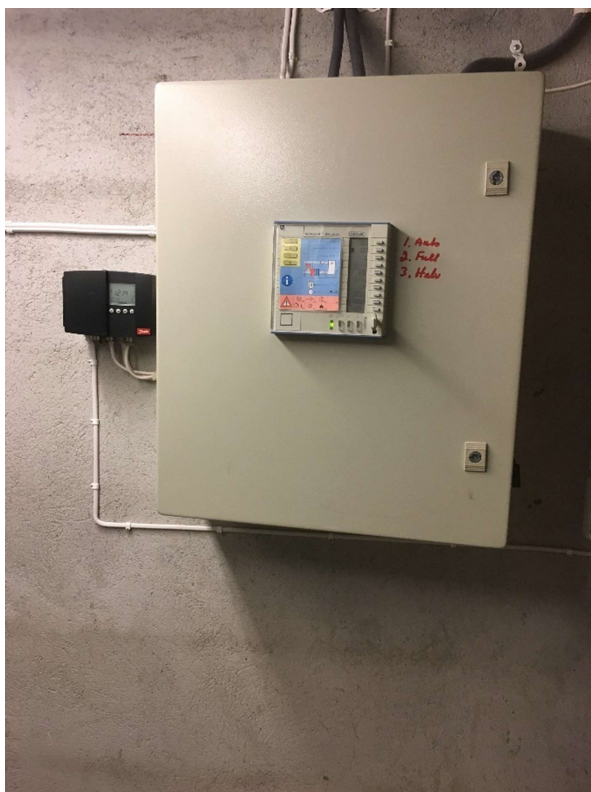
Figur 2.1.3.2– 11 Sikringssskap gymnal ventilasjonsanlegg
